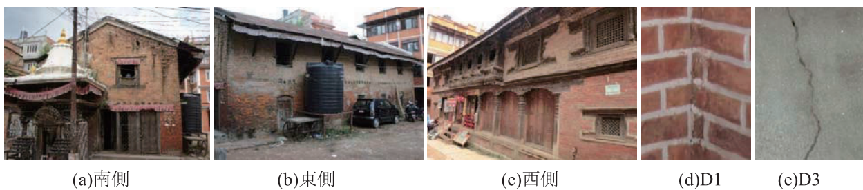
図1 ゴルカ地震後の建物の写真 ((a)(b)(c)は建物外観、(d)(e)は建物内のひび割れ写真) 6)
