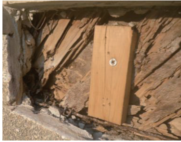
図12 土台外壁の蟻害
