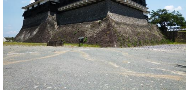
写真-4 天守周辺地盤の凹凸現象
