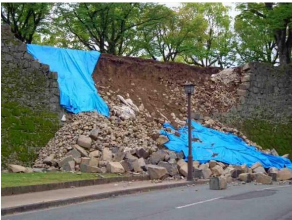
写真-5 石垣の崩壊断面
