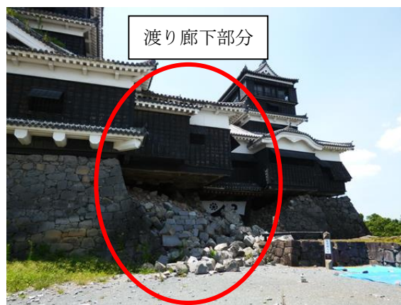
写真-2 大天守と小天守の間の石垣の被害
