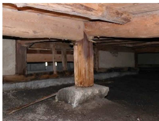
図 12 腐朽した柱脚部
