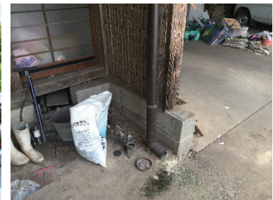
写真3 柱脚移動の例 (伝統・納屋)
