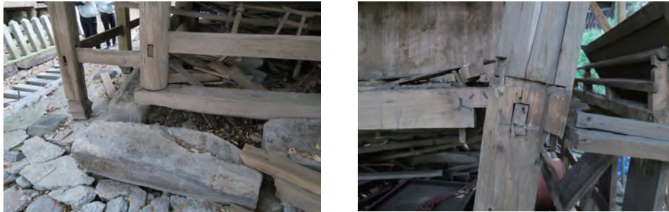
写真4 本殿1の被害状況2（左：崩壊した礎石と滑動した土台／右：柱-貫接合部）
