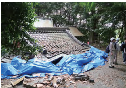
写真1 倒壊した拜殿
