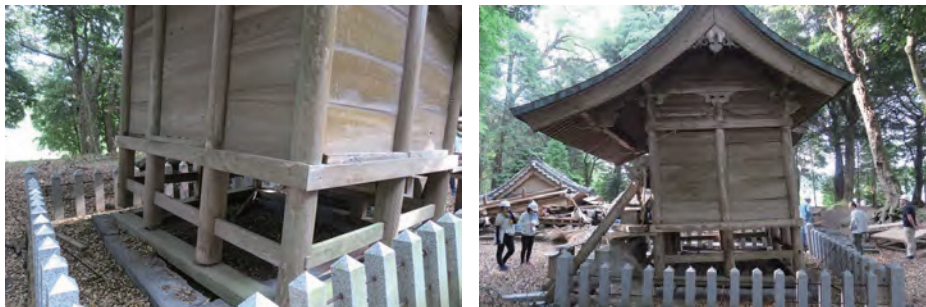
写真5 本殿2の被害状況（左：滑動した土台／右：全体の様子）
