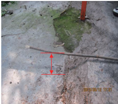
図7 路面の不同沈下
