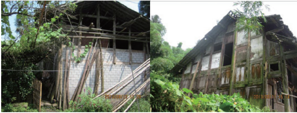
図9 被害の建造物
