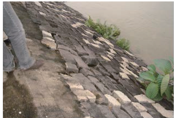
写真2 フォーン川河岸の変形、ブロックの欠落 1)
