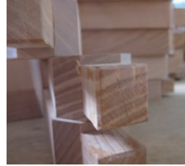
図18 ほぞ小口の亀裂
