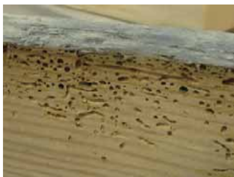
写真1 シバンムシによる劣化
