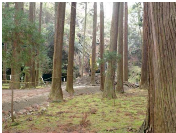
写真5 瑞巖寺参道沿い洞窟の崩壊箇所
