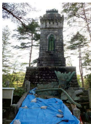
写真17 昭忠塔の崩壊
