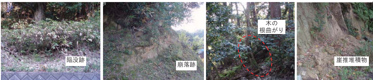
写真7 西側斜面崩壊跡(1) 写真8 西側斜面崩壊跡(2) 写真9 木の根曲がり 写真10 崖推堆積物
