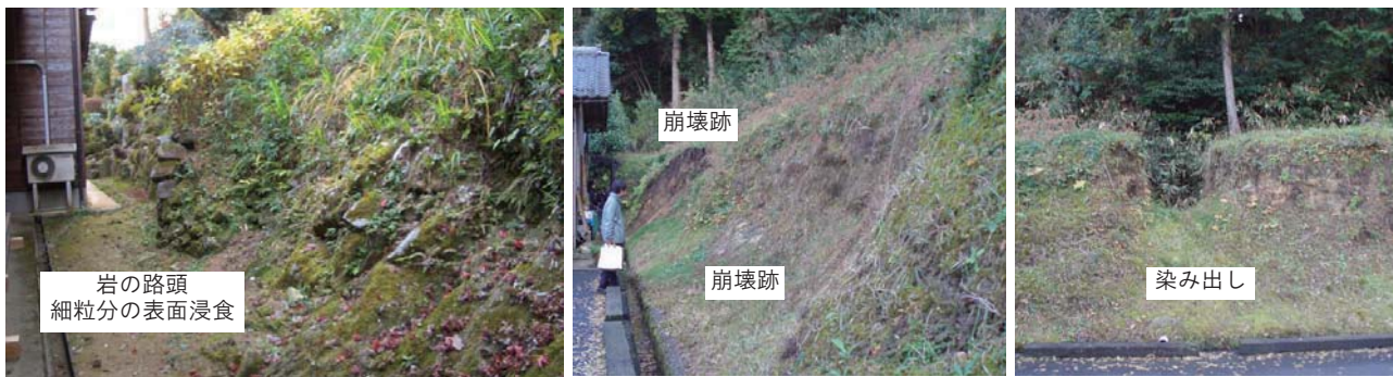
写真4 宝厳寺後背斜面 写真5,6 實相寺駐車場 後背斜面(南側)崩壊跡, (北側)浸潤斜面
