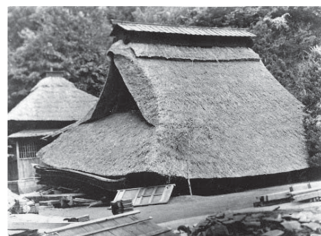
図5 円覚寺舍利殿の被災状況
