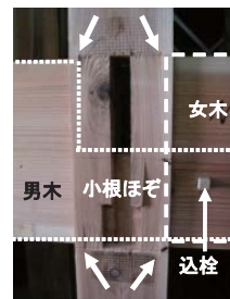
写真5 差鴨居による柱表面のめり込み痕跡
