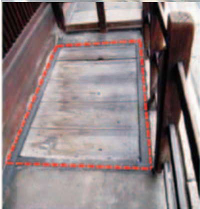
(d) 表の駒寄内の防火用水槽
