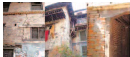
図 15. 経年劣化の事例
