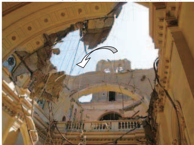
写真5 鐘楼上部落下で破壊したヴォールト天井、2007年
