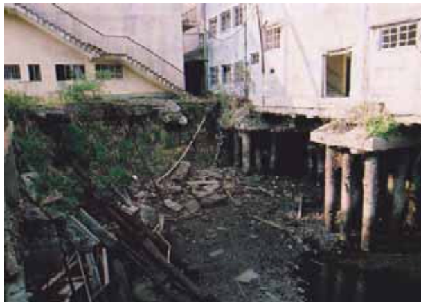
写真8 建物劣化状況の例(2)
