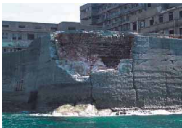
写真9 護岸の損壊状況(1) (現在、この破損箇所は修復済み)
