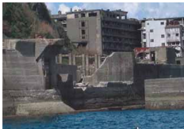
写真10 護岸の損壊状況(2)
