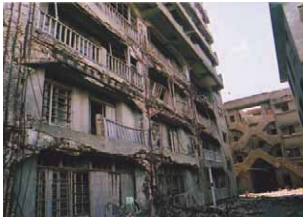
写真7 建物劣化状況の例(1)
