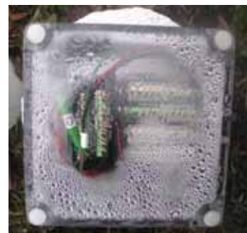
写真5 防水BOXの結露
