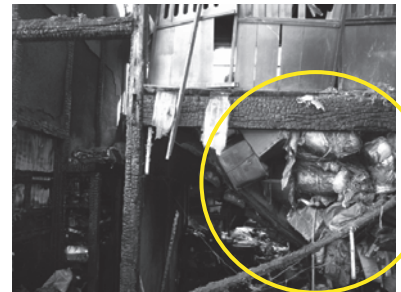
写真3 2階の積載物の状況
