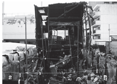
写真2 火災鎮火後の火災建物の状況
