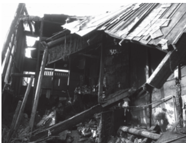
写真1 2階部分が崩落した状況
