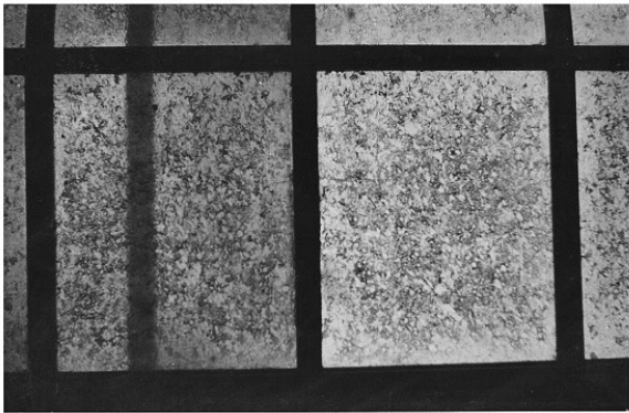
1. 九月二十一日残った校舎の二階の窓硝子に吹き付けられた泥砂、硝子を通して前方が見えない
