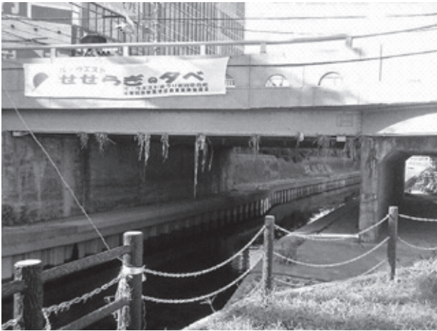
写真7 大和橋 (水害後：2013年8月20日)
