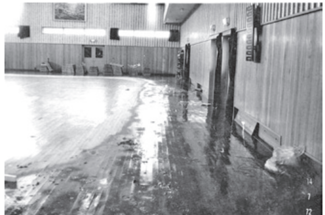
写真4 S小学校体育館内 (水害後：1972年7月14日)
