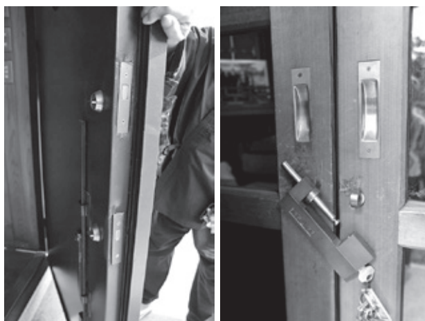
写真2 収蔵庫の扉における被害痕跡 （左：表の鉄扉、右：木製の内扉）
