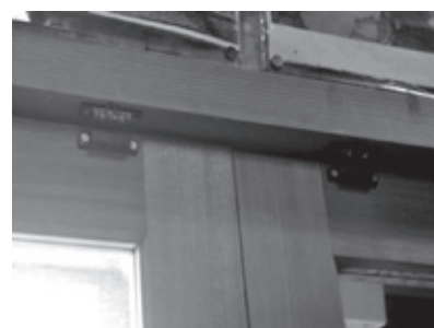
写真1 収蔵庫の内側上部に設置された侵入警報器
