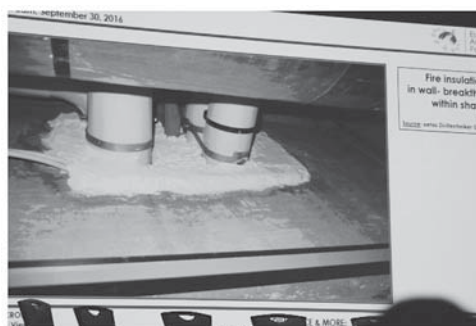
写真5 アスベストの使用例
