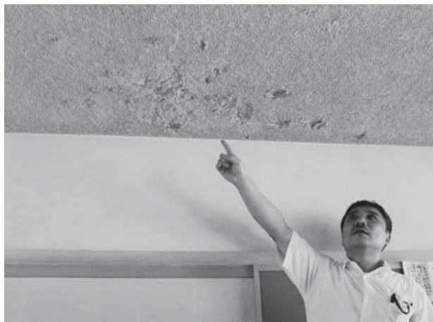
写真1 東京都練馬区内の小学校の天井吹付け。
