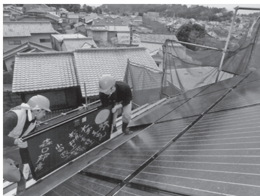
写真1：寄付者が名前を書き入れた太陽光パネルの設置 写真提供：きょうとグリーンファンド
