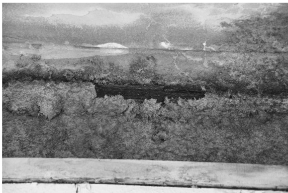
図3 吹付アスベストの一部が崩落している (いずれも著者により2019年2月10日に撮影)
