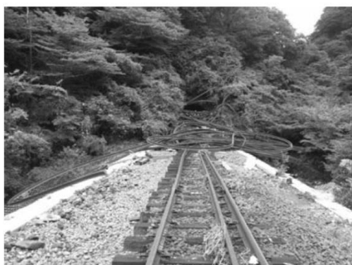
写真 1.1.7 坂の上トンネルの被災状況 9) (起点側坑口のレールの損傷状況)
