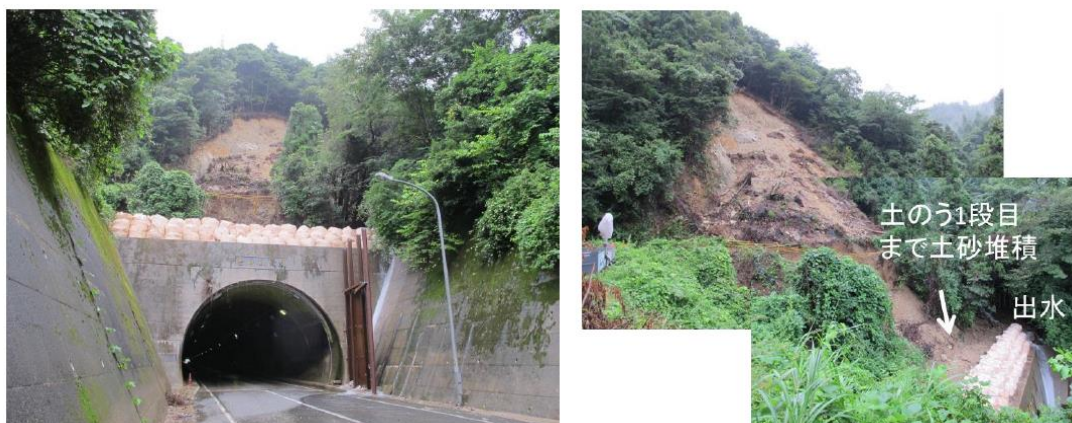
(a) 坑口部の崩壊状況
