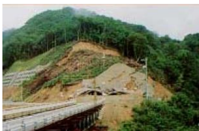
写真 1.1.6 子持トンネル坑口部の崩壊 8)
