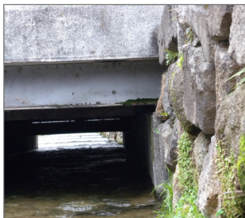
写真3 菊屋橋下の送水管
