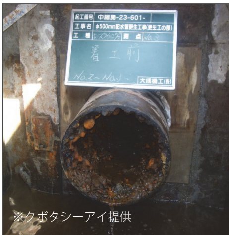
写真2-1 錆こぶが形成された鉄管
