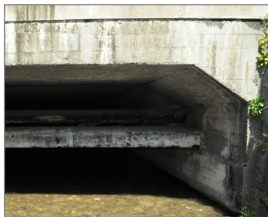
写真5 高瀬川アンダーパスの送水管
