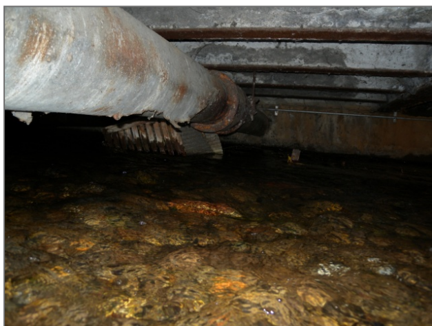
写真2 白川橋下の送水管
