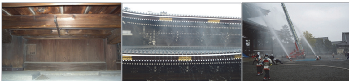
・床下のスプリンクラー ・御影堂のドレンチャー ・御影堂前の放水銃
