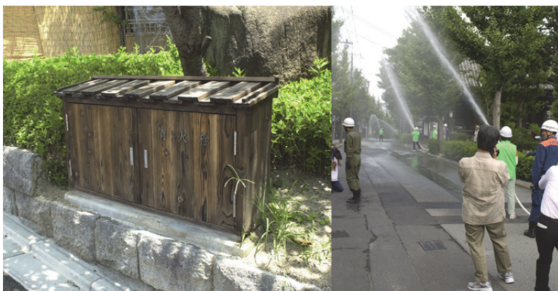
図3-5 易操作性1号消火栓とその使用（事例：清水周辺地域）
