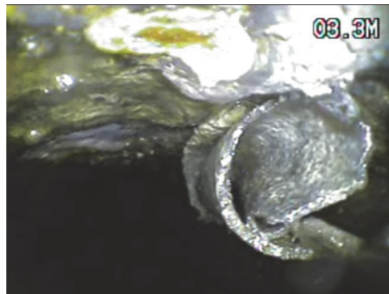
写真 2-8 剥落された管内（五条大橋下）
