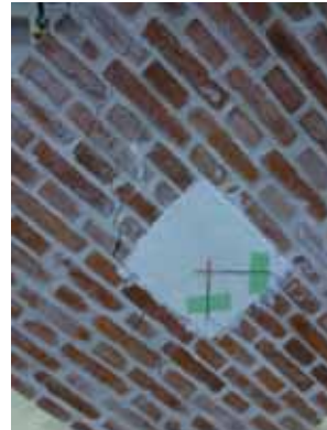
写真10 補強供試体に生じた亀裂
