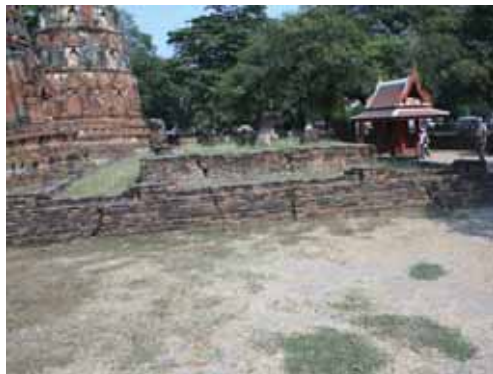
写真6 構造物に亀裂が発生
