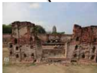
F地点：レンガ劣化、沈下
