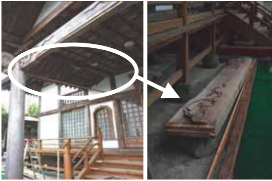
写真2 向拝の虹梁が落下した被害例 (栗原市一迫真坂)
