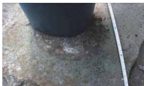
写真 1 礎石から柱がずれた被害例 (栗原市栗駒岩ヶ崎茂庭町)
