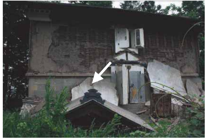
写真4 庇屋根が倒壊した被害例 (栗原市一迫柳目)
