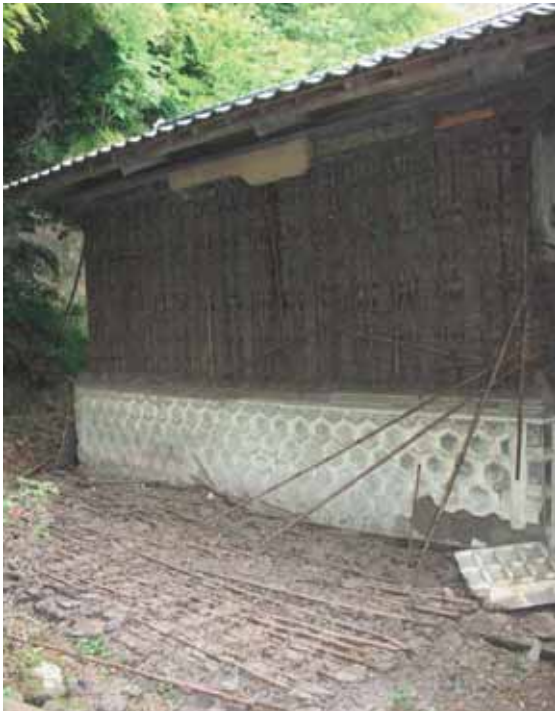
写真3 土壁の被害例 (栗原市一迫萩生)
