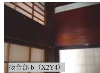
写真2 被害部位の様子
