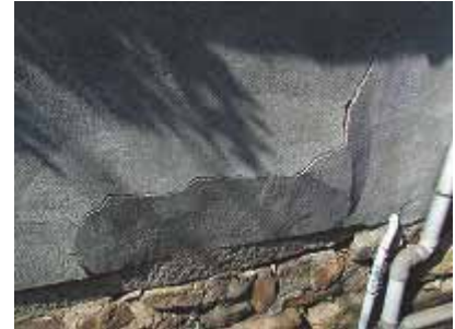
写真7 外壁のひび割れ
