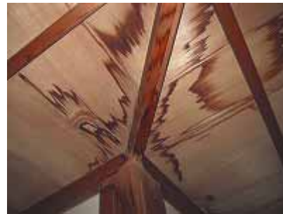
写真9 天井の雨漏り
